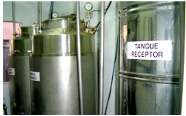
Planta de Tratamiento de efluentes independiente
