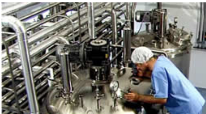
Sistema de transferencia de producto
